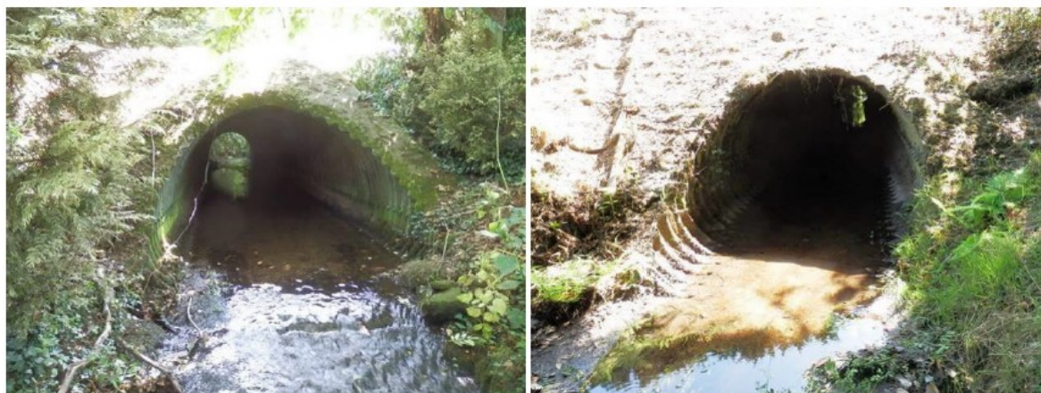
Vue sur l'ouvrage hydraulique actuel du ruisseau du Pont-Neuf (à gauche) et de son bief (à droite)
